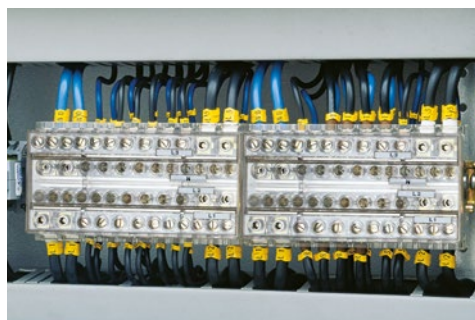
Ejemplos de uso de los repartidores tipo Z50-DP12-160 y Z35-DP14B-125 en cuadros eléctricos de distribución
